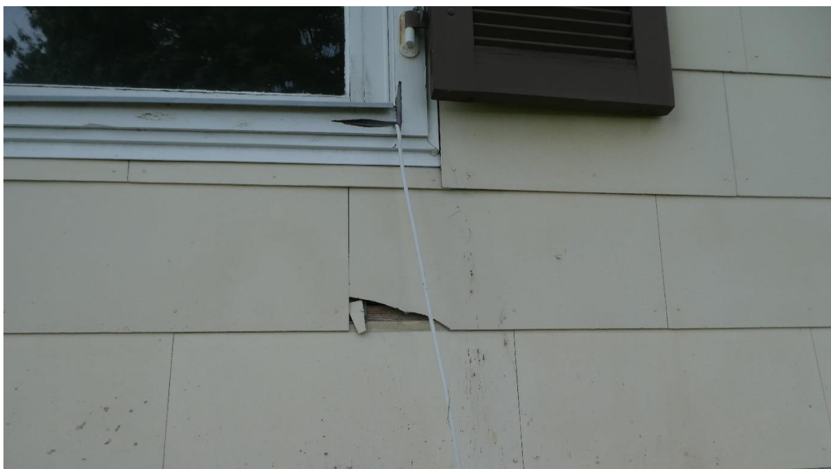
Abbildung 3: Hölzerne Fensterläden und Spalten in der Fassade des Gebäudes
